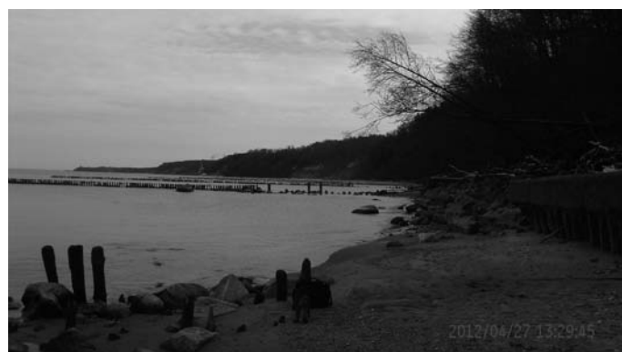
Rys. 11. Przykład starych mocno zniszczonych budowli brzegowych na zachód od Swietłogorska (okolica miejscowości Otriadnoje)
