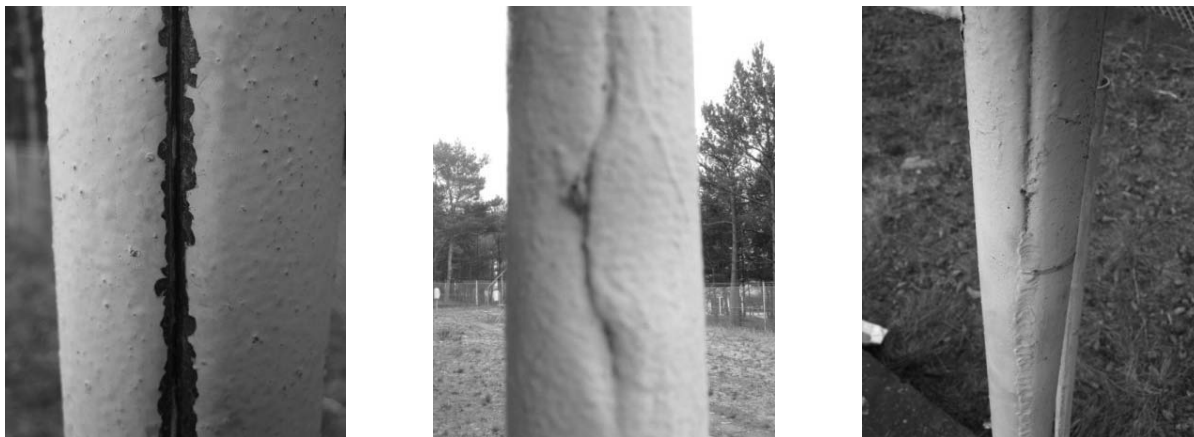
Rys. 7. Rura w miejscu szwu podłużnego
