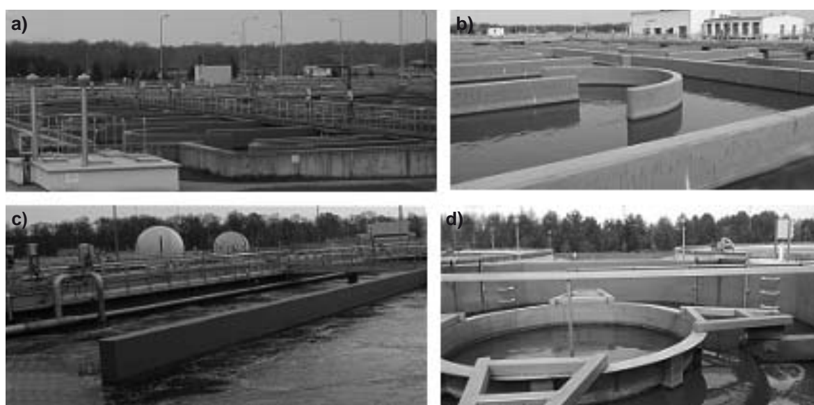
Rys. 8. Linia ściekowa a) mieszacze, b) aktualnie eksploatowana komora mieszania, c) napowietrzanie, d) osadnik radialny ( D = 48 m)
