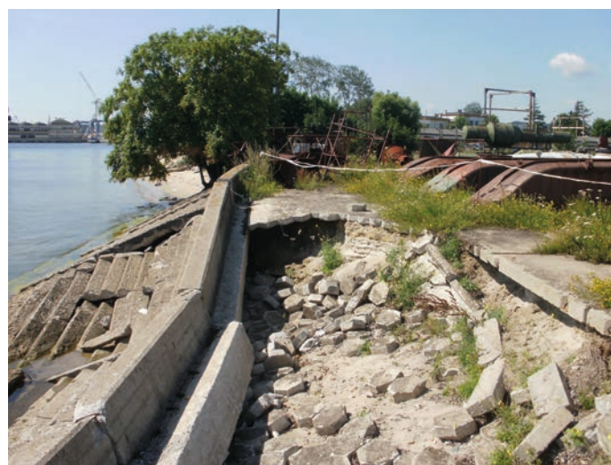
Rys. 5. Zapadlisko w części lądowej poza konstrukcją opaski brzegowej
