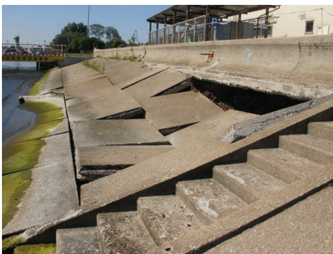
Rys. 3. Widok uszkodzonego zabezpieczenia skarpy opaski brzegowej
