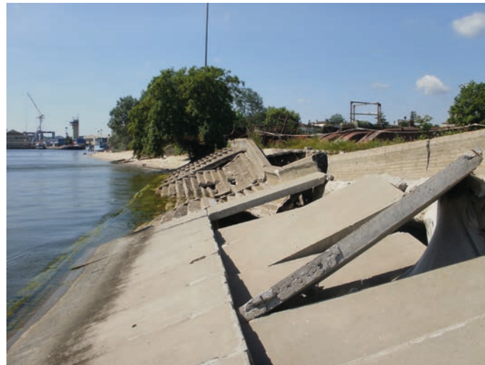
Rys. 4. Uszkodzona część nadwodna opaski brzegowej
