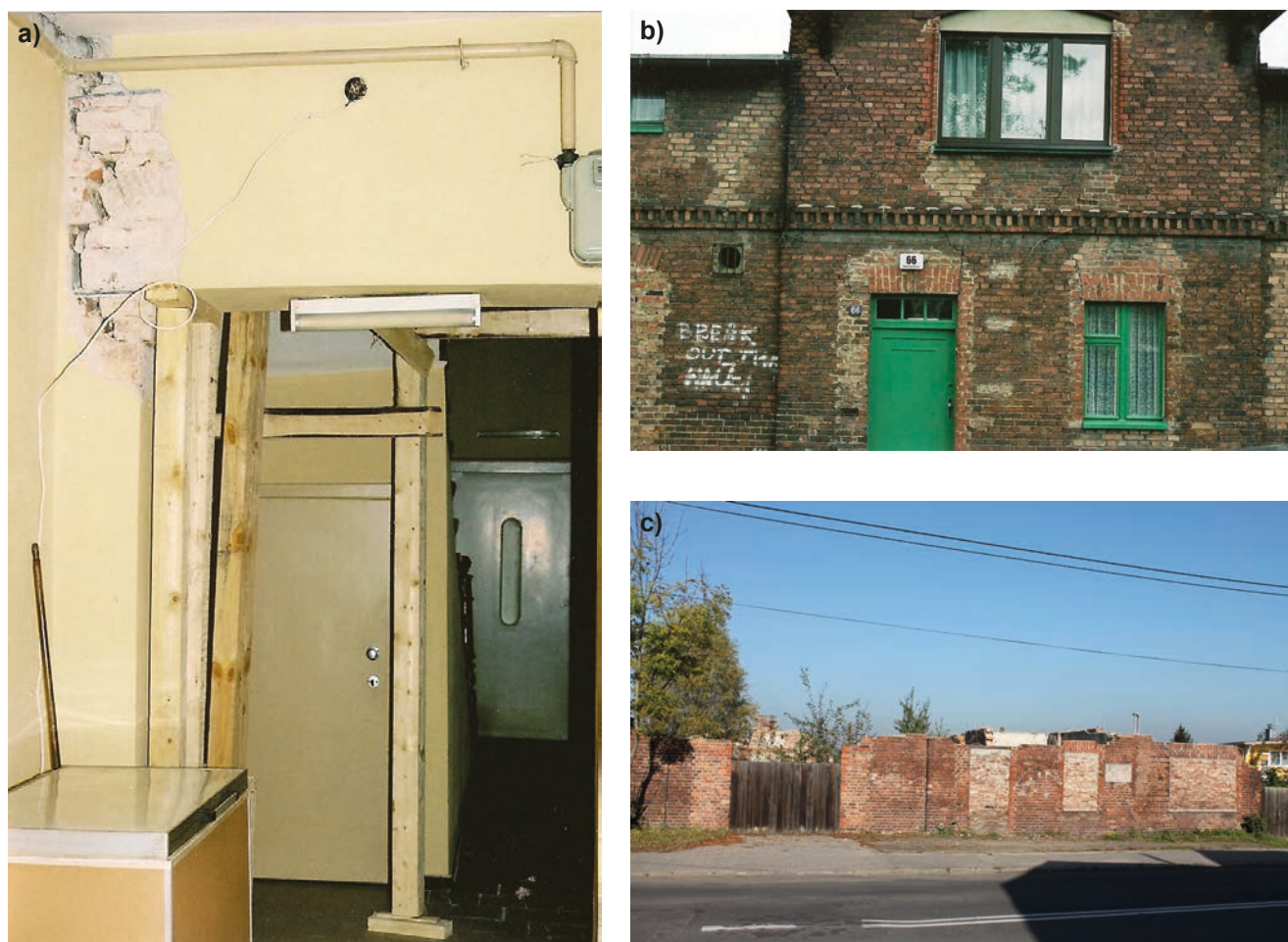
Rys. 2. Uszkodzenia budynku położonego na wypukłym obrzeżu niecki górniczej, przy równoczesnym oddziaływaniu progu terenowego pod budynkiem a) spękanie i zabezpieczenie nadproża klatki schodowej, b) spękania ściany frontowej– stan w 2002 roku, c) stan budynku w 2014 roku
