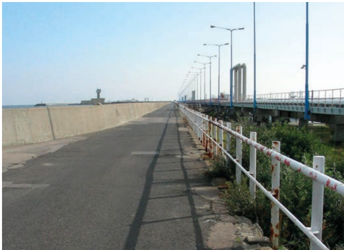
Rys. 21. Falochron Półwyspowy Północny (2008) – przed wymianą nawierzchni
