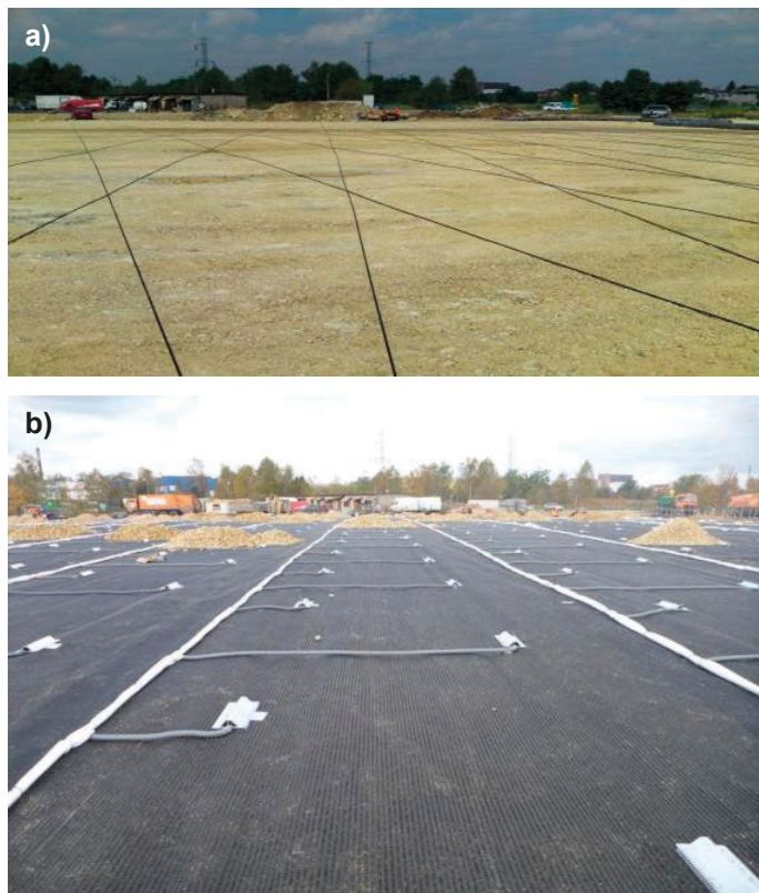
Rys. 10. Instalacja systemu monitoringu
