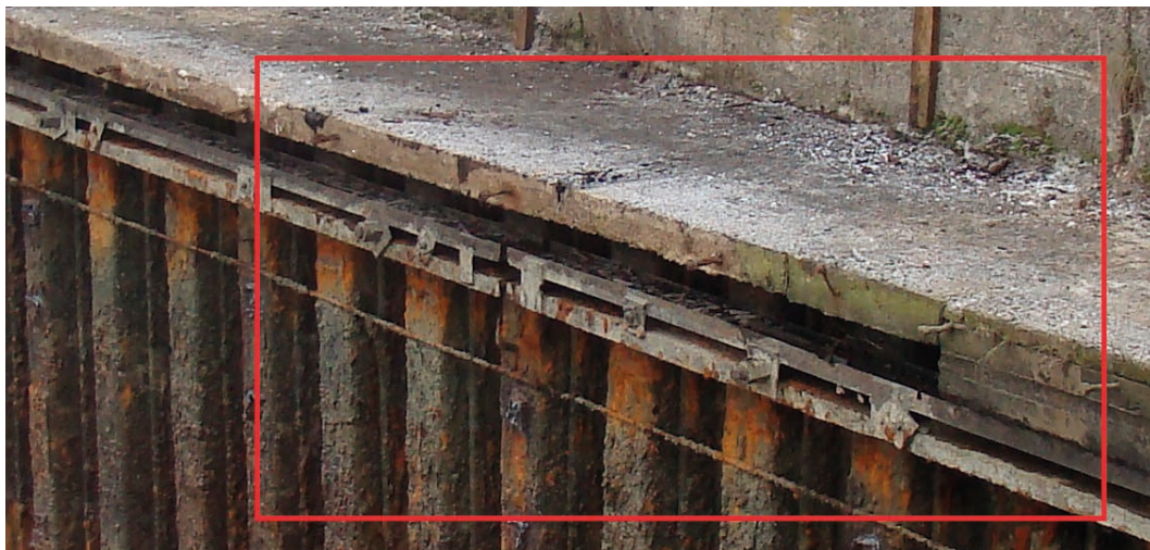
Rys. 6. Korozja ścianki Nabrzeża Przemysłowego (fot. własna [9])
