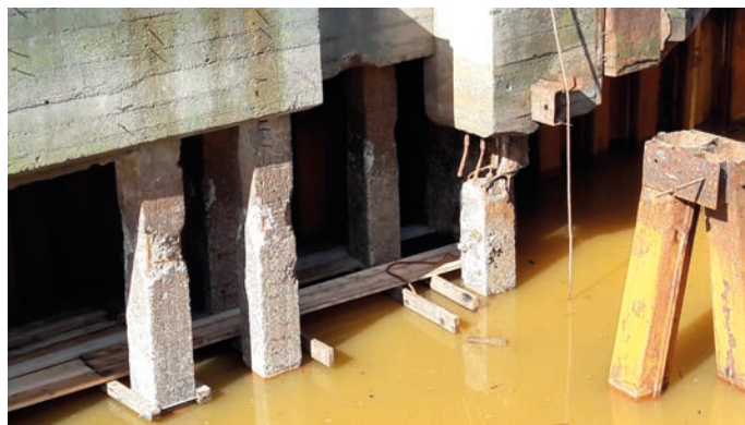
Rys. 5. Uszkodzenia betonu pali i głowicy wnętrza pomostu uchylnego
