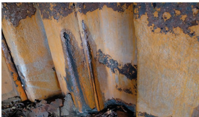
Rys. 2. Uszkodzenia korozyjne stali ścianki Larssen III
