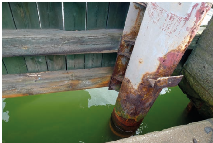
Rys. 3. Korozja pali stalowych prowadnic promowych
