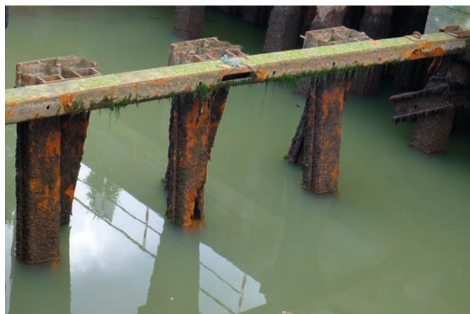
Rys. 4. Stan stalowej belki czołowej oraz podpór z kozłowych pali skrzynkowych
