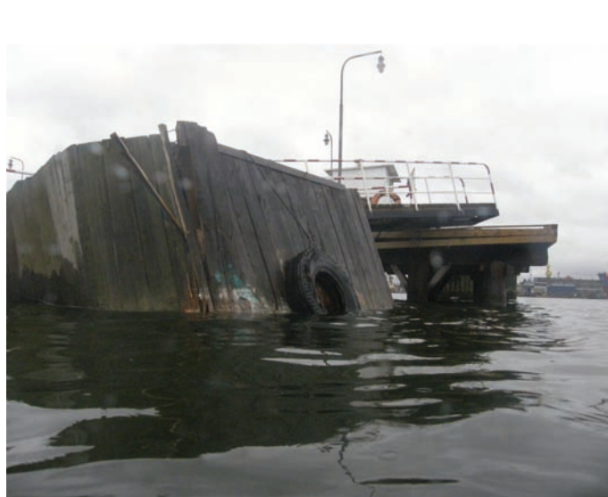
Rys. 7. Widok uszkodzonej dalby nr 3 i fragmentu czoła nadbudowy pomostu przeładunkowego (na opierzeniu nadbudowy dalby wyraźny ślad zderzenia z rufy statku powłoki zabezpieczającej)
