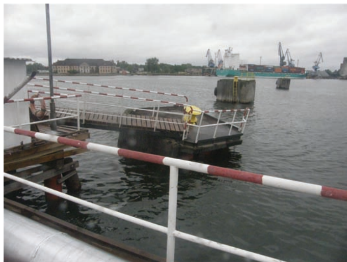
Rys. 6. Widok uszkodzonej dalby (widoczna część akwenu obrotnicy, a w głębi widoczny cumujący przy nabrzeżu Szczecińskim, zatrzymany statek m/v CHRISTOPHER)
