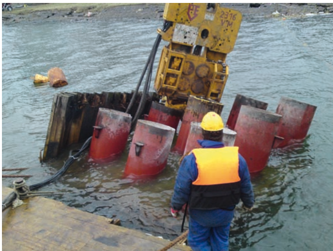
Rys. 3. Wyrwanie pali uszkodzonej dalby za pomocą wibromłota (ponad zwierciadłem wody widoczne, po demontażu nadbudowy dalby, głowice pali przemieszczone w wyniku uderzenia statku)
