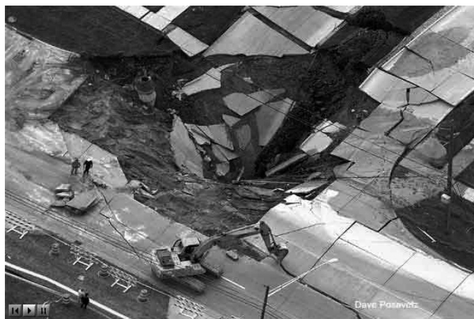
Rys. 9. Awaria kanału w Sterling Height [15]
