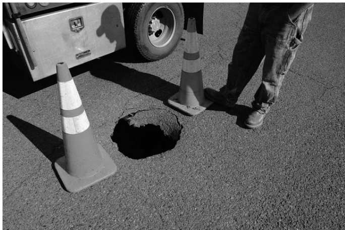
Rys. 1. Awaria kanału w Vancouver [15]
