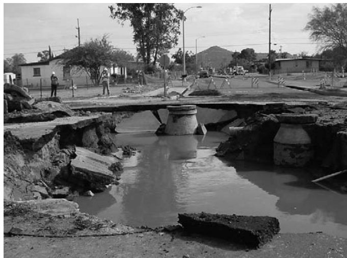
Rys. 8. Awaria kanału w Tucson [2]
