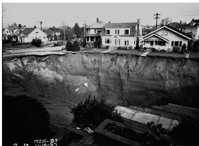
Rys. 6. Awaria kanału w Seattle [2]
