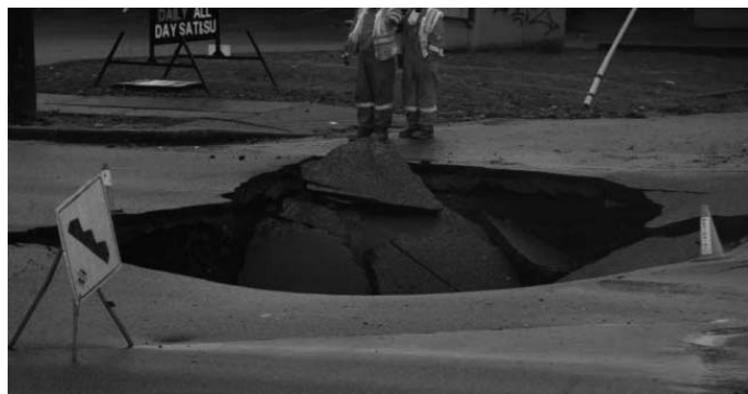
Rys. 4. Awaria kanału w Vancouver [15]
