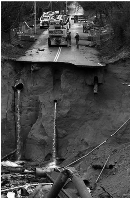
Rys. 10. Awaria kanału w Shoreline [15]
