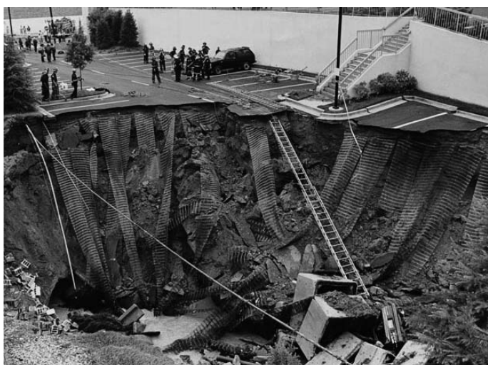
Rys. 11. Awaria kanału w Atlancie [15]
