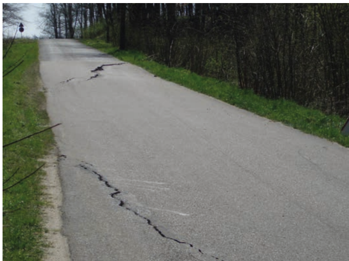
Rys. 2. Zasięg górnej krawędzi niszy osuwiska – widok z kierunku północnego
