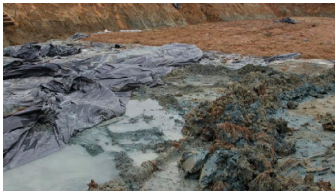
Rys. 3. Dno wykopu ze zdegradowaną strefą łu, również pod słomą i folią ochronną
