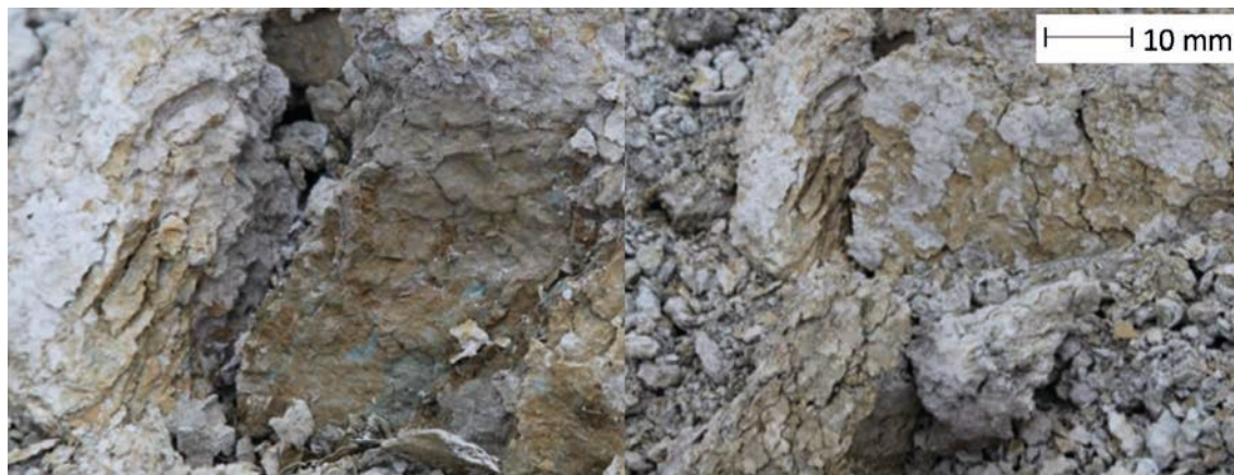
Rys. 6. Skutki mrozowej degradacji i pęcznienia warstwy łu-cement
