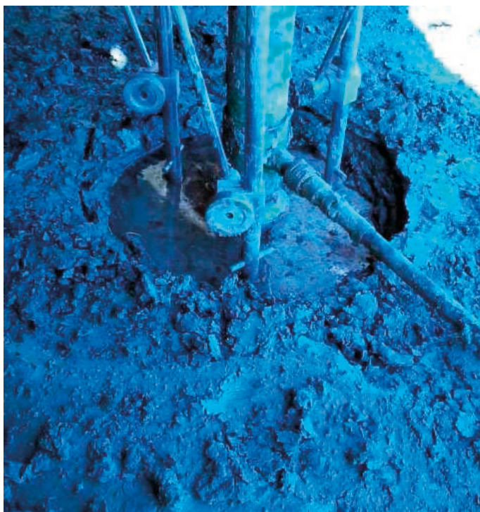
Rys. 2. Deformacja warstwy stabilizowanej podczas badań VSS (płyta zapadła się)
