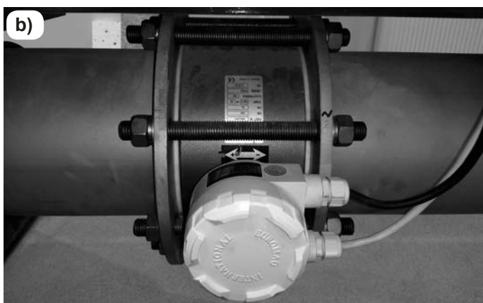
Rys. 3. Oprzyrządowanie kanału: system pomiaru wysokości wody (a) i przepływomierz (b)
