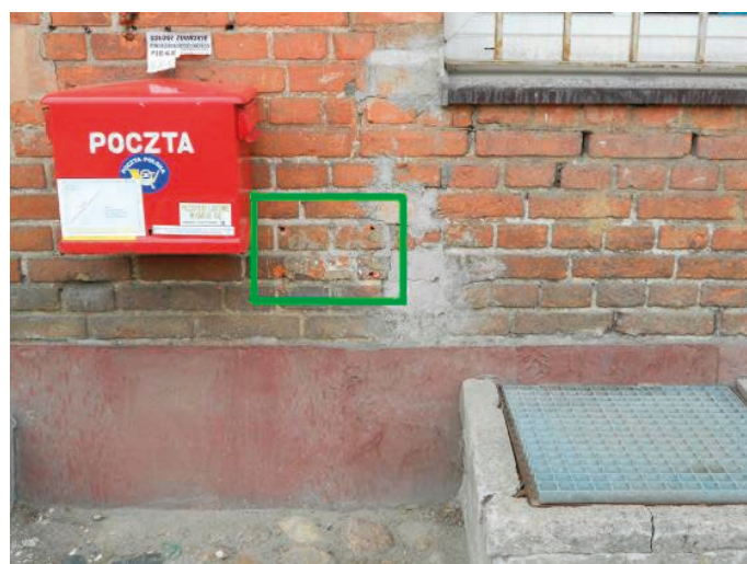
Rys. 12. Miejsce, w którym znajdował się znak wielkiej wody na ul. Trakt św. Wojciecha 434 (16.05.2012)
