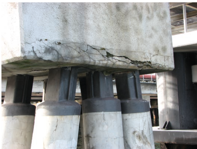
Rys. 3. Widok podpory nr 1 przed podjęciem prac remontowych (widoczna korozja dolnej części bloku podpory)
