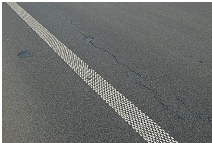
Rys. 5. Widok na podłużne spękania jezdni
