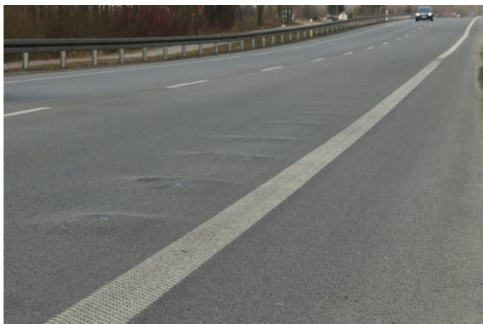
Rys. 4. Widok uszkodzeń jezdni
