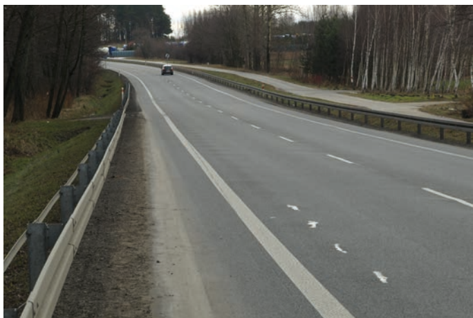
Rys. 2. Widok uszkodzeń jezdni
