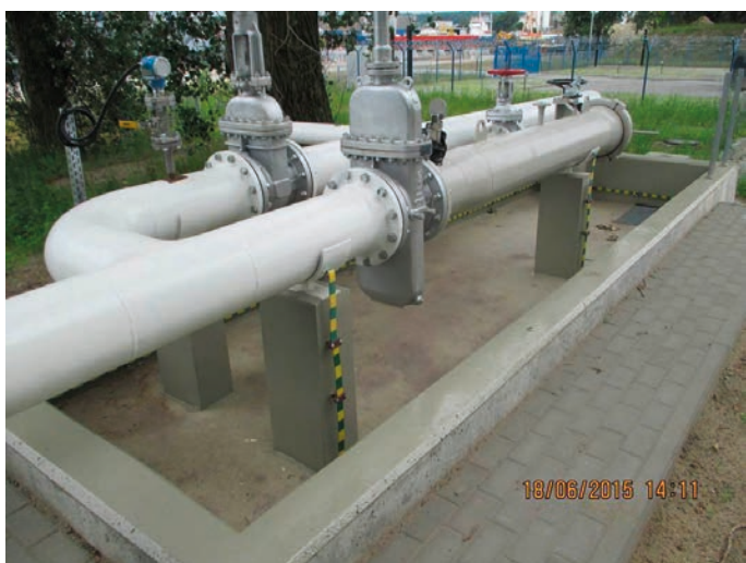
Rys. 4. Stacja czyszczaków na betonowej tacy
