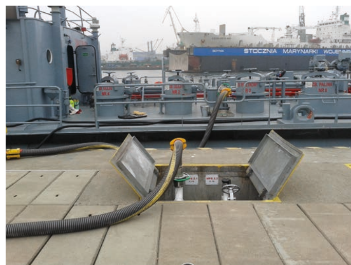
Rys. 8. Studzienka dystrybucji paliw (MPS) na nabrzeżu z elastycznym węzem połączonym na okręcie
