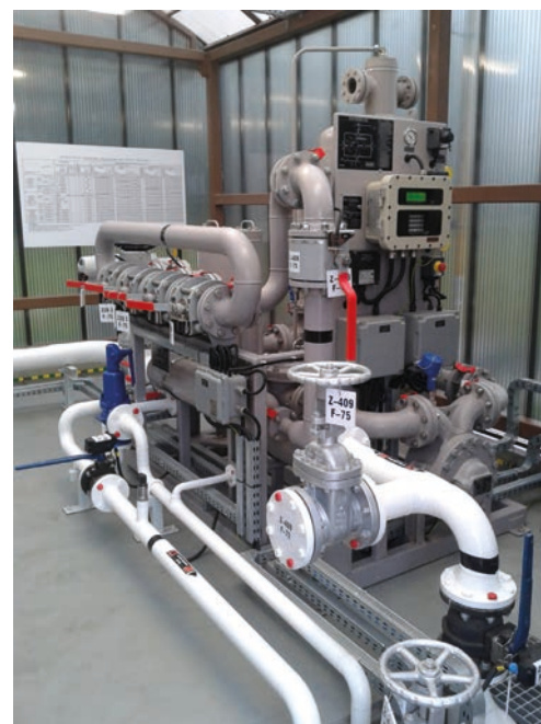
Rys. 7. Widok modułu zespołu pomiarowego zainstalowanego w budynku Stacji Pomiarowej
