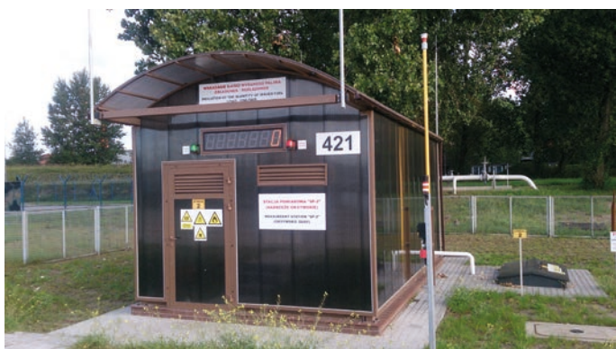
Rys. 5. Budynek Stacji Pomiarowej (z wyświetlaczem wielkogabarytowym i lampkami sygnalizacyjnymi); Obok budynku zbiornik resztkowy oraz na słupku ręczny ostrzegacz pożaru
