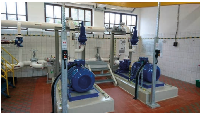
Rys. 13. Nowe agregaty pompowe w Pompowni ekspedycyjnej
