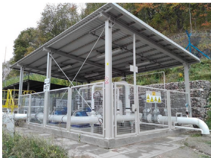
Rys. 15. Widok Pompowni podporowej wraz z instalacją tłoczną
