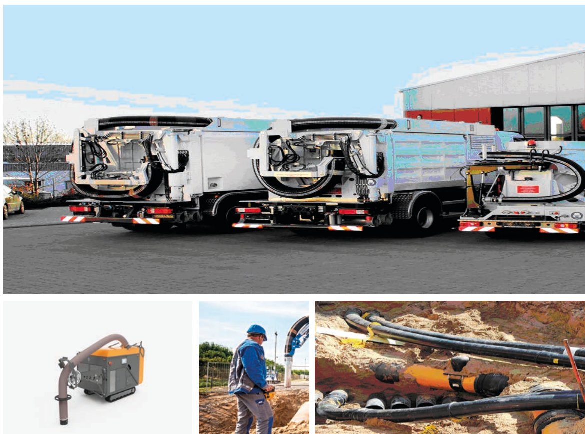
Rys. 1. Koparki ssące, opracowano na podstawie stron internetowych firmy KANRO
