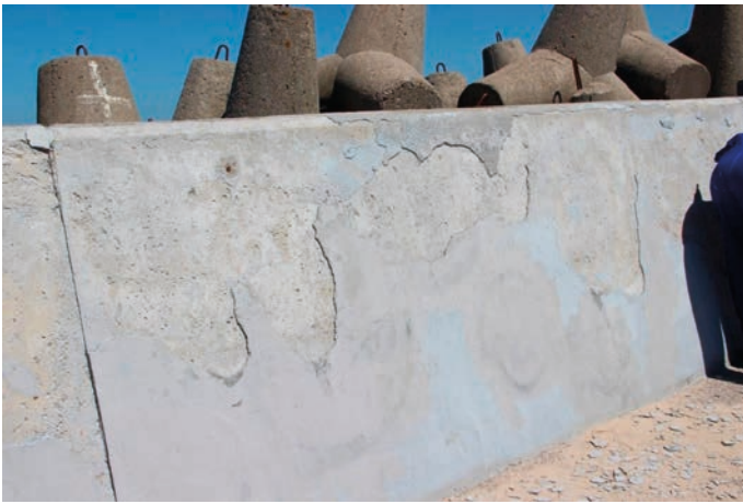
Rys. 6. Element falochronu – odspojenia powłoki ochronnej
