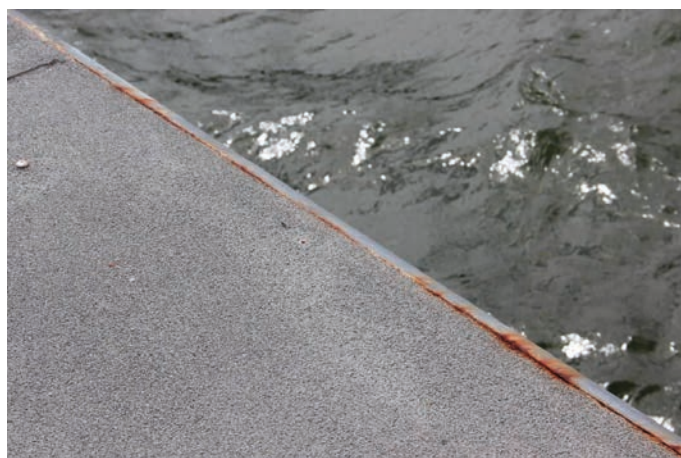
Rys. 4. Trakt pieszy przy kanale – korozja na styku stal – beton
