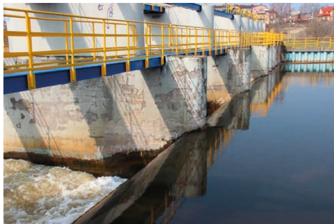
Rys. 2. Zniszczenia korozyjne jazu ujęcia wody
