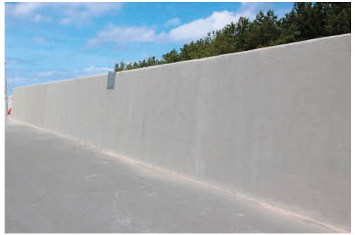
Rys. 10. Falochron po naprawie systemowej z powłoką polimerowo-cementową.
