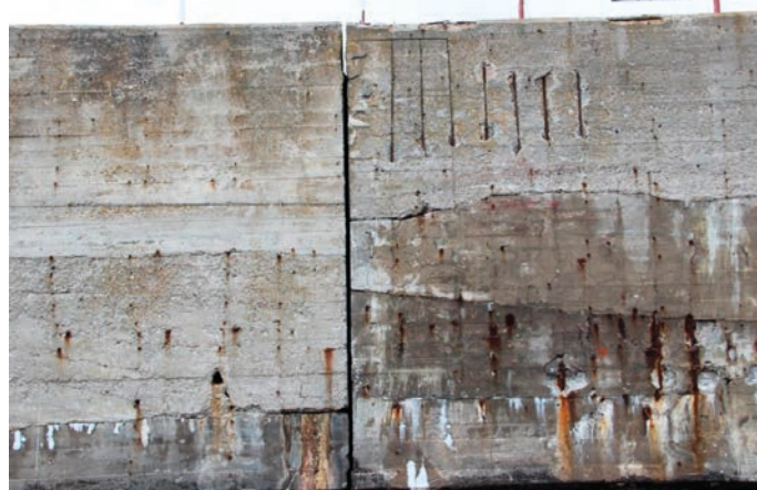
Rys. 1. Efekty korozyjne – fragment nabrzeża
