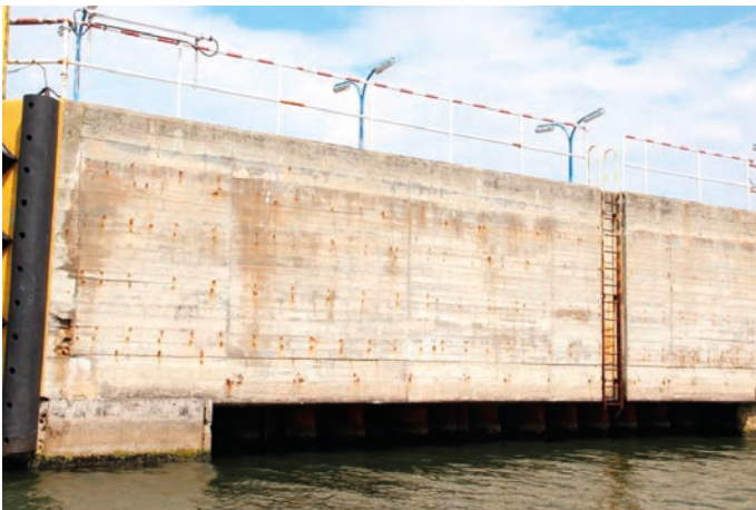
Rys. 8. Ściana pirsu z efektami korozyjnymi
