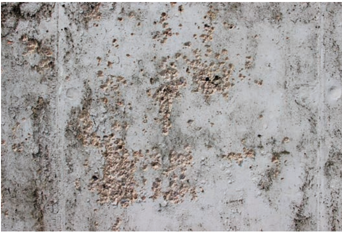
Rys. 7. Element falochronu – zniszczenia korozyjne
