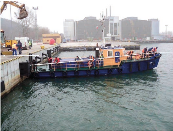
Rys. 13. Widok montażu (z wody) na nabrzeżu w Porcie Wojennym w Gdyni instalacji paliwowej do zaopatrzenia okrętów
