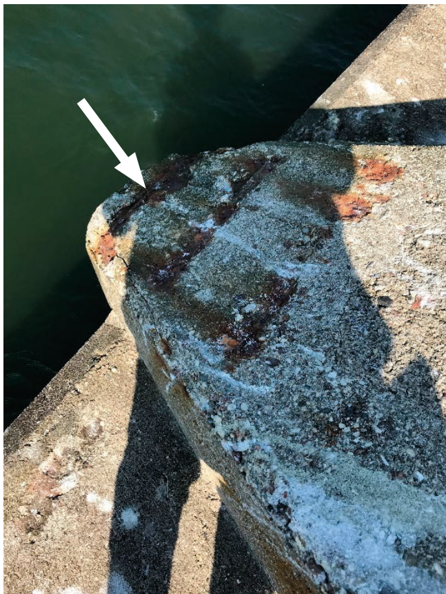
Rys. 4. Widoczne pręty zbrojeniowe na szykanie (aut. Paweł Chudziak)
