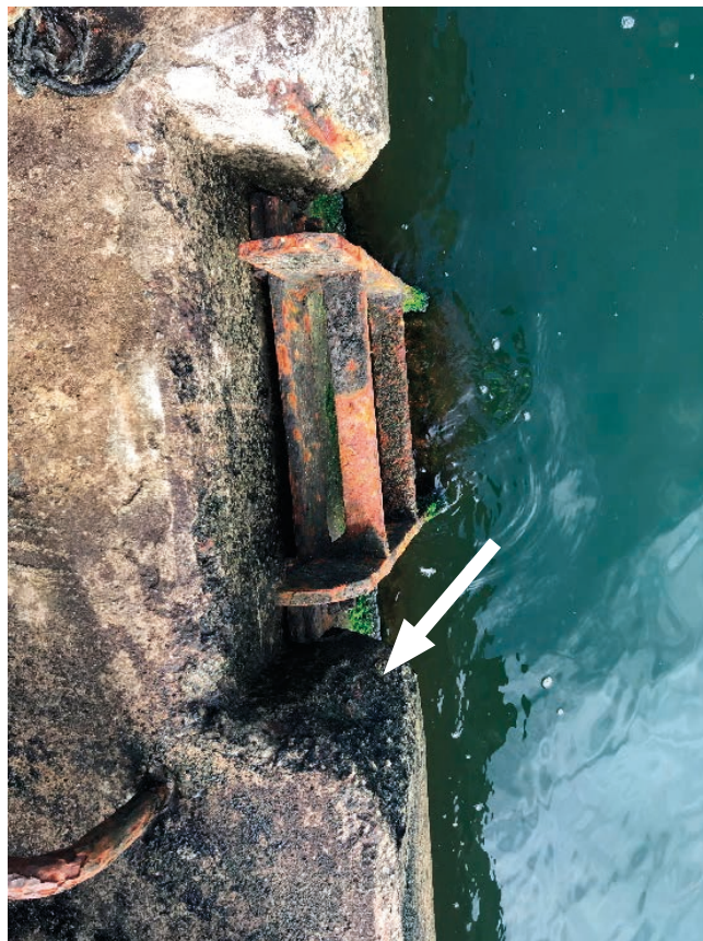
Rys. 5. Ubytki w betonie (aut. Paweł Chudziak)
