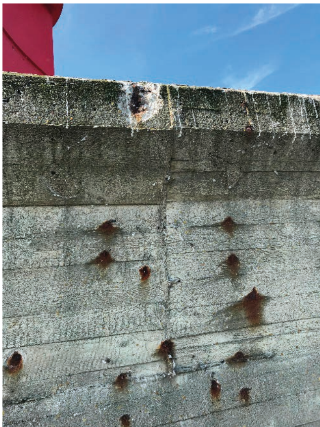
Rys. 6. Widoczna korozja prętów zbrojeniowych oraz ubytek w łamaczu fal (aut. Paweł Chudziak)
