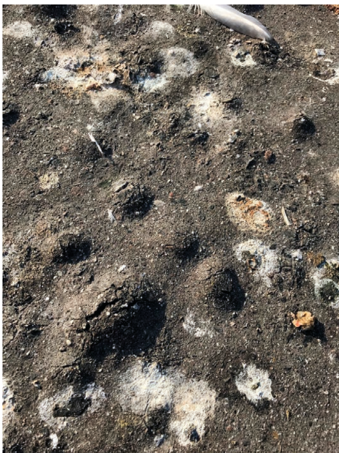
Rys. 1. Uszkodzenia dywanika asfaltowego (aut. Paweł Chudziak)
