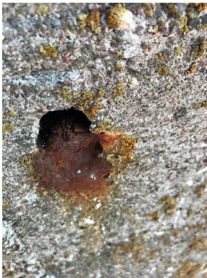
Rys. 2. Efekty korozji chemicznej (aut. Paweł Chudziak)
