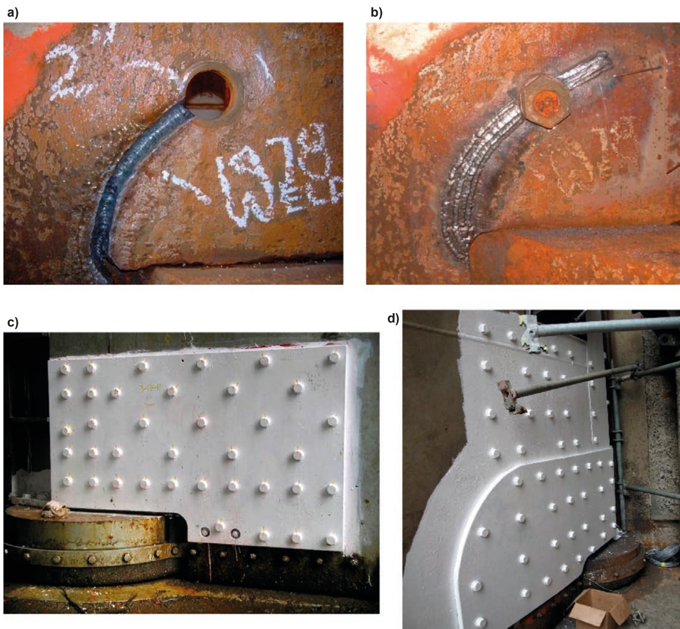
Rys. 11. Przykłady napraw rys zmęczeniowych we wrótach śluz: a, b) nieudana naprawa przez wiercenie otworu na końcu rysy; c, d) naprawa nakładkami mocowanymi na śruby sprężające
