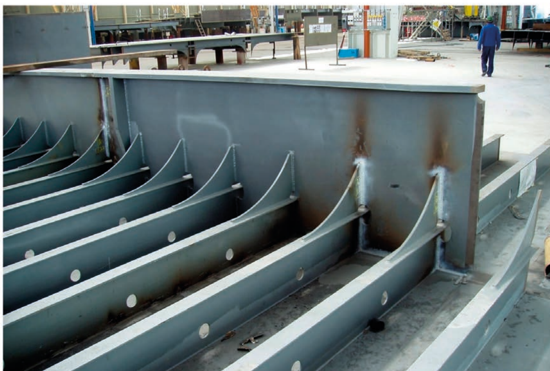
Rys. 9. Szczegóły wrót o dużej (a) i małej (b, c) podatności na zmęczenie [15]
