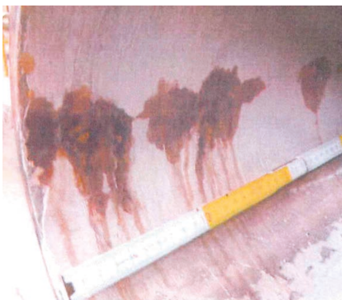
Rys. 4. Próbkę kanału żeliwnego z uszkodzoną powłoką wewnętrzną [2]
